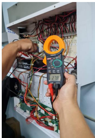
รูปที่ 5.6 ทำการตรวจวัดแรงดันไฟฟ้าของแบตเตอรี่
