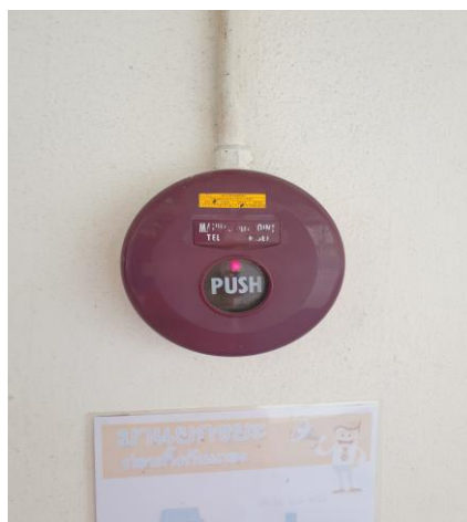
รูปที่ 5.7 ทำการทดสอบการทำงานตัวกดแจ้งเหตุเพลิงไหม้ Manual Station
