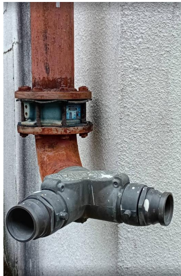
ภาพหัวรับน้ำดับเพลิงอาคารจุฬารณีย์
